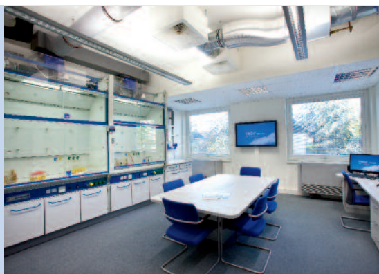
Демонстрация работы системы в лаборатории TROX, Нойкирхен-Флюн, Германия
