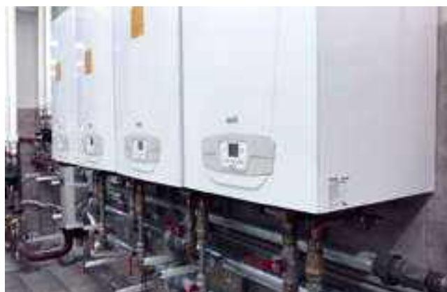
Общежитие, г. Усть-Луга Общая мощность котельной - 300 кВт
