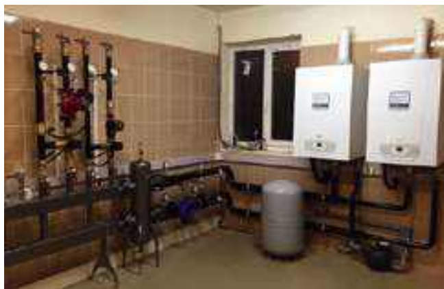
Автосервис, г. Москва Общая мощность котельной - 300 кВт
